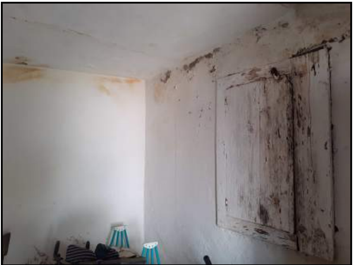
Foto 30. Altra vista pareti e soffitto civico 17
