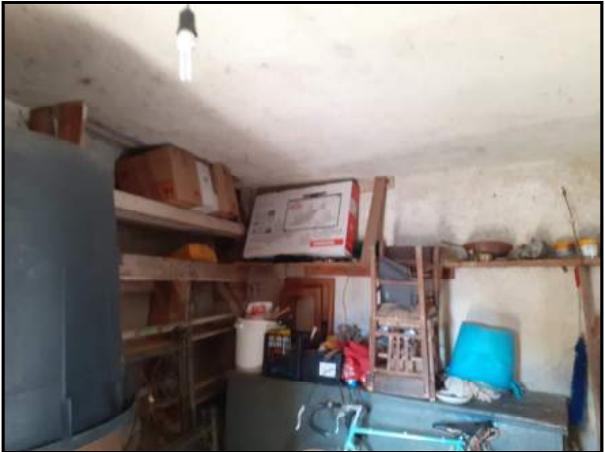
Foto 23. Muri e soffitto locale cantina
