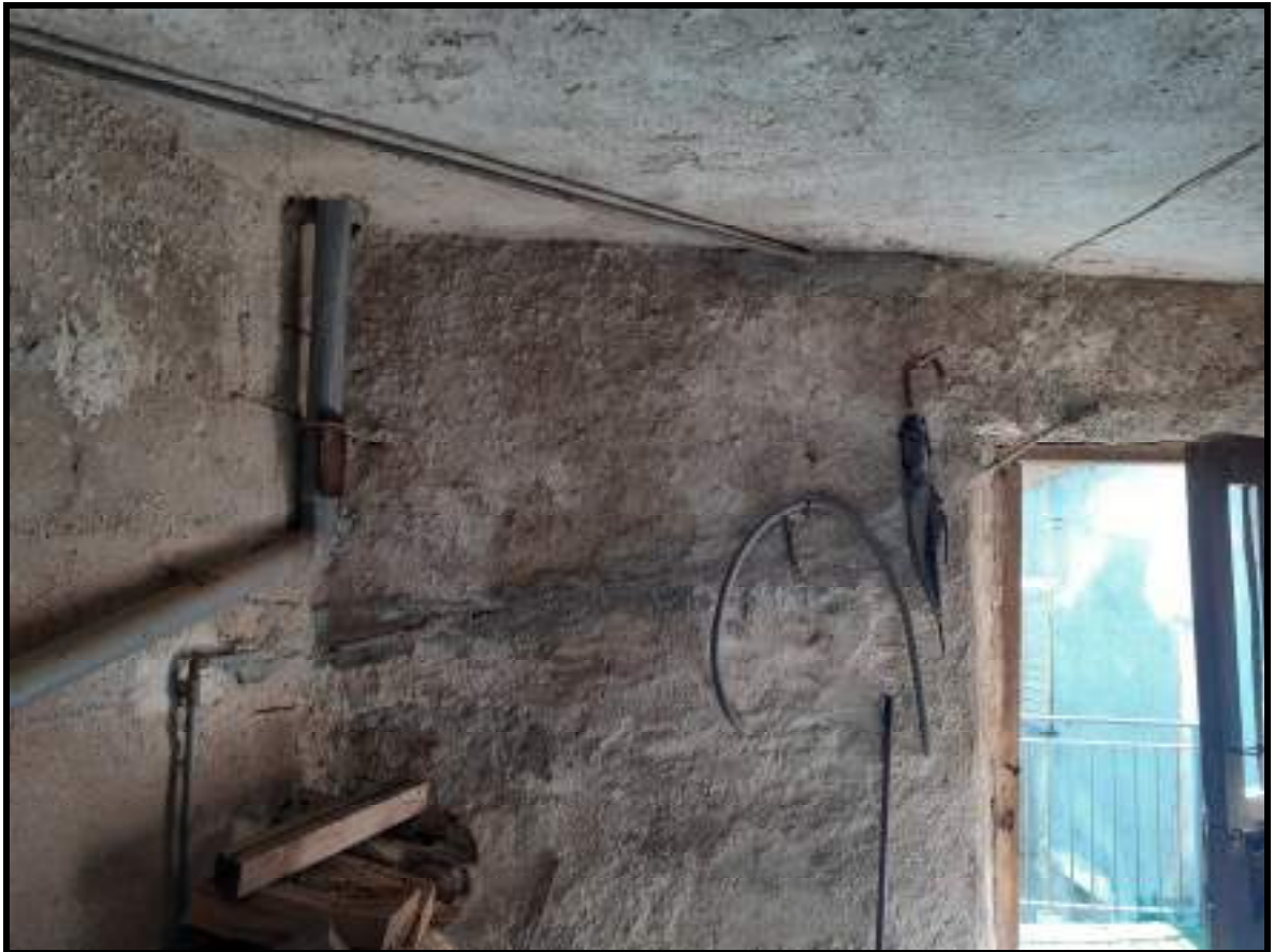
Foto 21. Ingresso muri e soffitto cantina al civico 21
