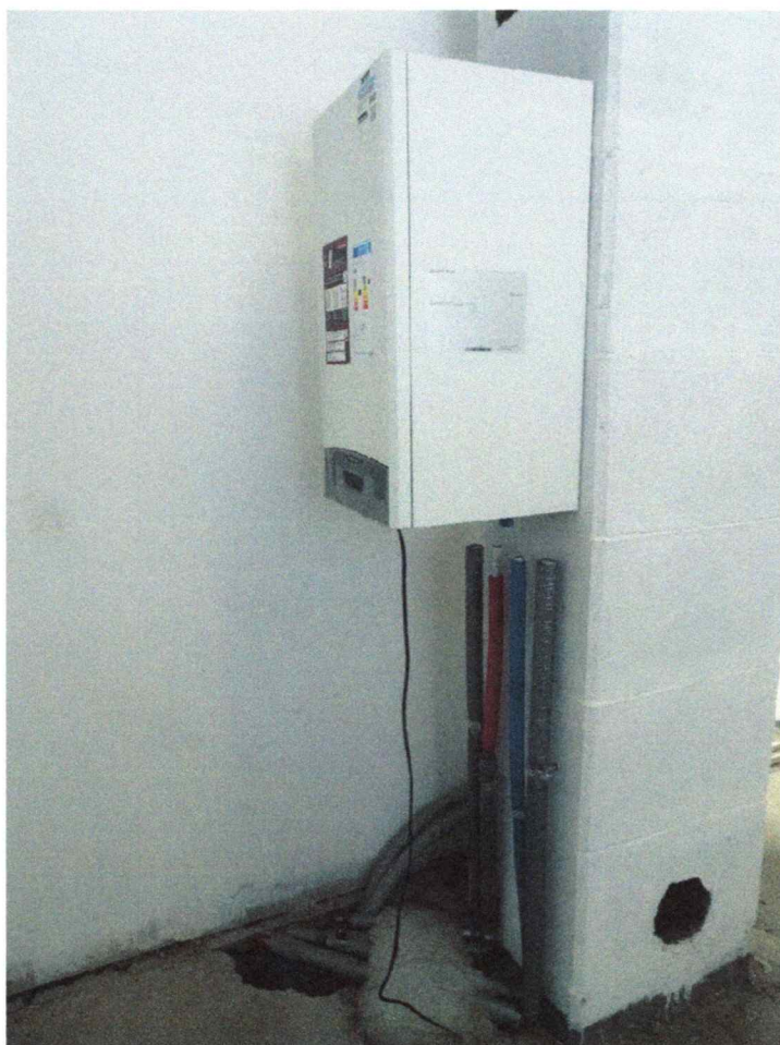
- Locale caldaia primo piano
