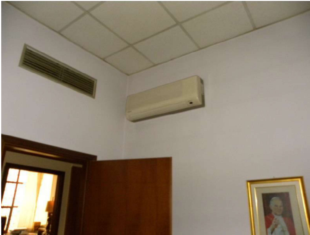
Dettaglio impianto di raffrescamento
