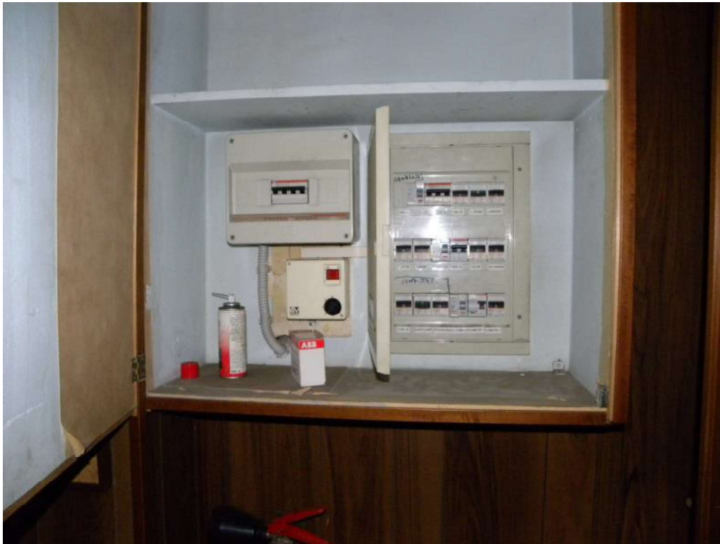
Dettaglio quadro elettrico
